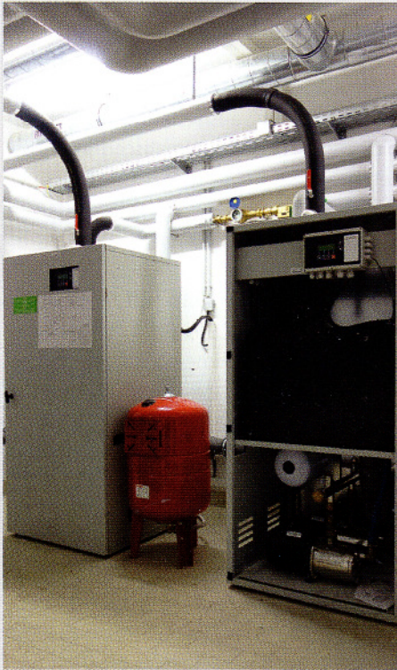
Bild 5 Regenwassernutzung: Normgerechte Anlagen sind serienmäßig wie Trinkwassertrennstationen mit der Sicherheitseinrichtung „freier Auslauf“ ausgestattet, die bei ausbleibendem Regen automatisch Trinkwasser liefert.
